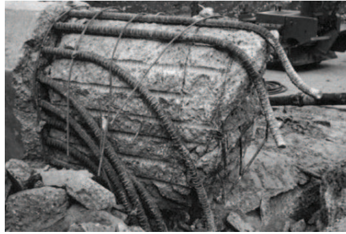
Fig. 2.19 – Rotura da ligação do pilar à sapata. [8]
