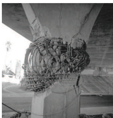
Fig. 2.21 – Rotura por esforço transversal na zona de variação de seção transversal no pilar de uma ponte do sismo de Northridge em 1994. [8]
