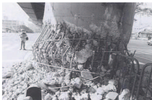
Fig. 2.20 - Rotura do pilar por flexão devido a ductilidade insuficiente. [11]
