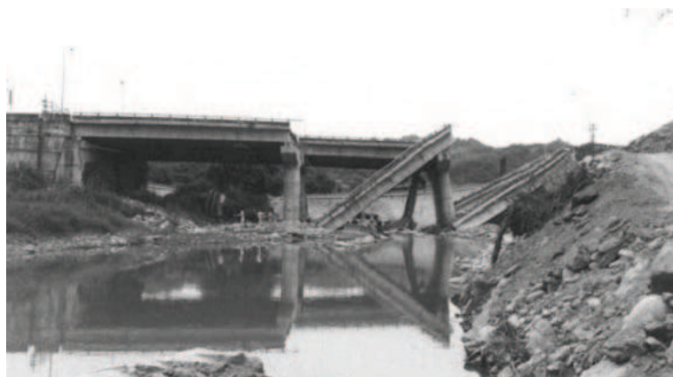
Fig. 2.17– Colapso do vão simplesmente apoiado devido ao deslizamento do solo, Taiwan em 1999 [8]
