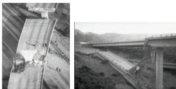
Fig. 2.26 – Colapso do tabuleiro nos viadutos durante o sismo de Northridge em 1994 [11]
