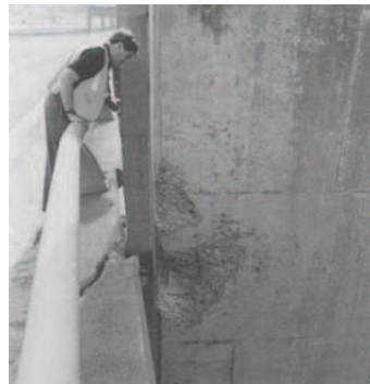
Fig. 2.27 – Efeito de pounding entre a superestrutura e o pilar de um viaduto (sismo de Loma Prieta, 1989) [11]
