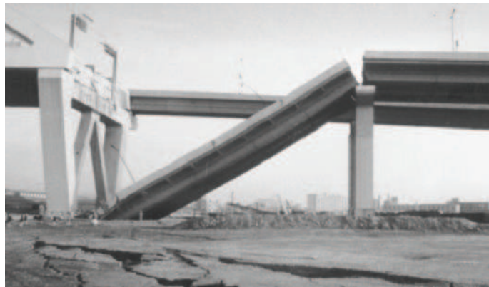
Fig. 2.16 - Colapso do vão simplesmente apoiado devido à liquefação do solo [8]
