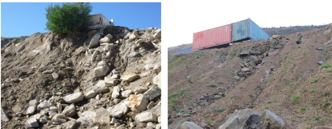
Figura 5.7 – Taludes instáveis que podem colocar em causa pessoas e bens (risco de erosão).
