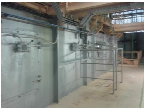
Figura 4.10 – Queimador - Central de Valorização Energética
