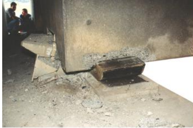
Figura 2.20 Rotura de um Shear-key (Turquia, 1999)
