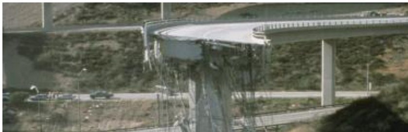
Figura 2.19 Colapso de um viaduto devido à subestimação dos deslocamentos
