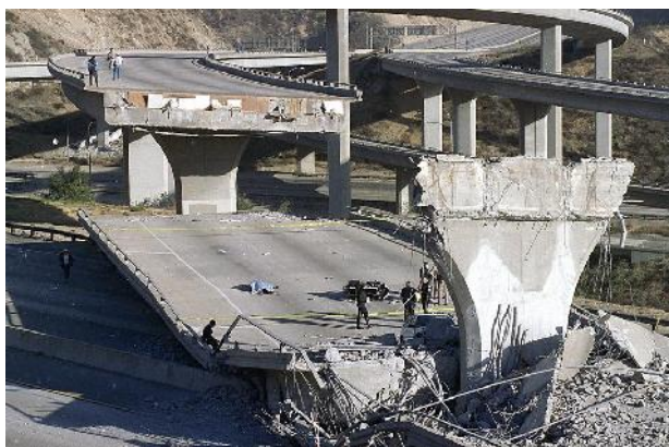
Figura 2.4 Queda de um viaduto devido a deslocamento excessivos (Northridge, 1994)
