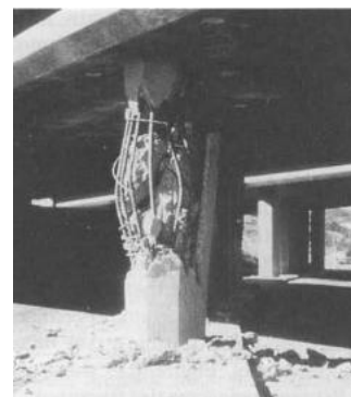
b) Rotura por corte em zona fora de formação de rótula plástica (San Fernando, 1971)
