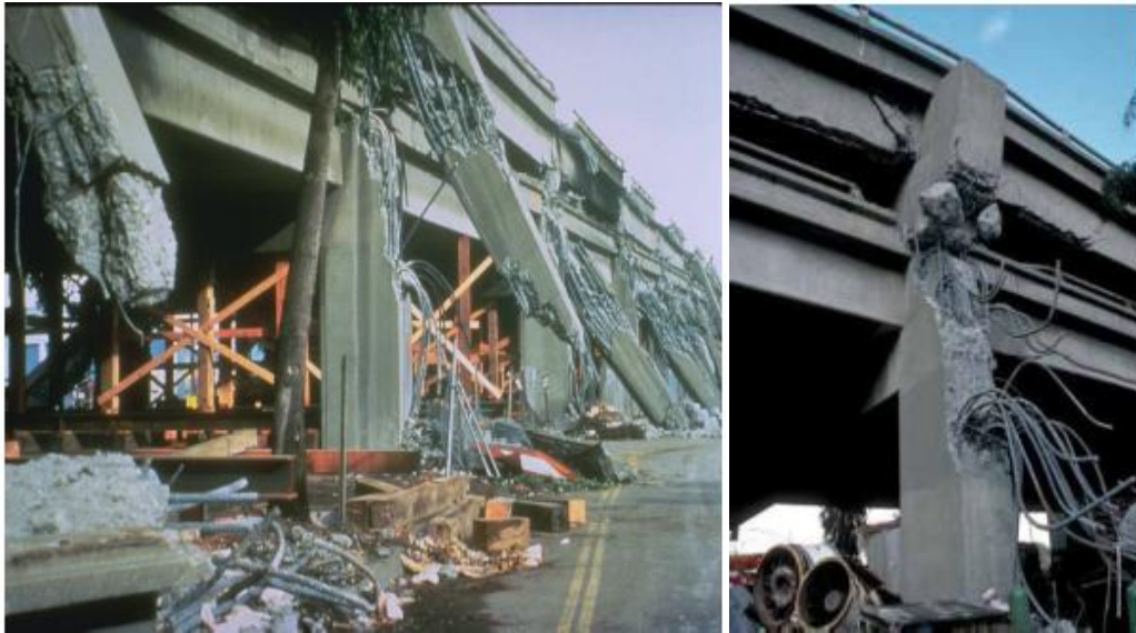
Figura 2.8 Rotura do viaduto de Cypress devido a rotura dos nós (Loma Prieta, 1989)
