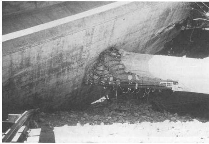
Figura 2.24 Dano consequente ao mau confinamento do betão (San Fernando 1971)
