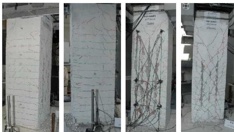
a) Face Norte b) Face Sul c) Face Este d) Face Oeste Figura 3.10 Danos no pilar PO1-N4 no final do ensaio
