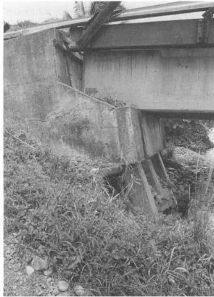
Figura 2.11 Rotura do encontro da ponte sobre o rio Banano (Costa Rica, 1990)
