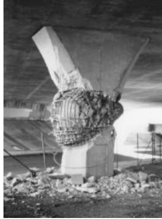
Figura 2.32 Rotura por corte em pilar curto (Northridge, 1994)
