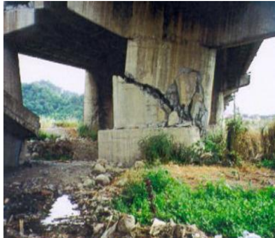
Figura 2.30 Rotura frágil por corte (Taiwan, 1999)
