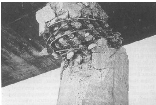
a) Rotura por corte em zona de formação de rótula plástica (San Fernando, 1971)
