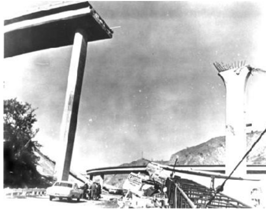
Figura 2.2 Rotura do viaduto da intersecção entre Route 14 e 5 (San Fernando, 1971)
