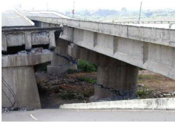
Figura 2.33 Rotura por corte em pilar curto e falha nos apoios
