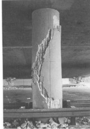
Figura 2.28 Rotura por corte (Northridge, 1994)
