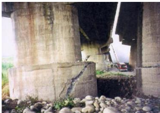
Figura 2.16 Rotura da fundação devido a elevado esforço transverso (Taiwan, 1999)
