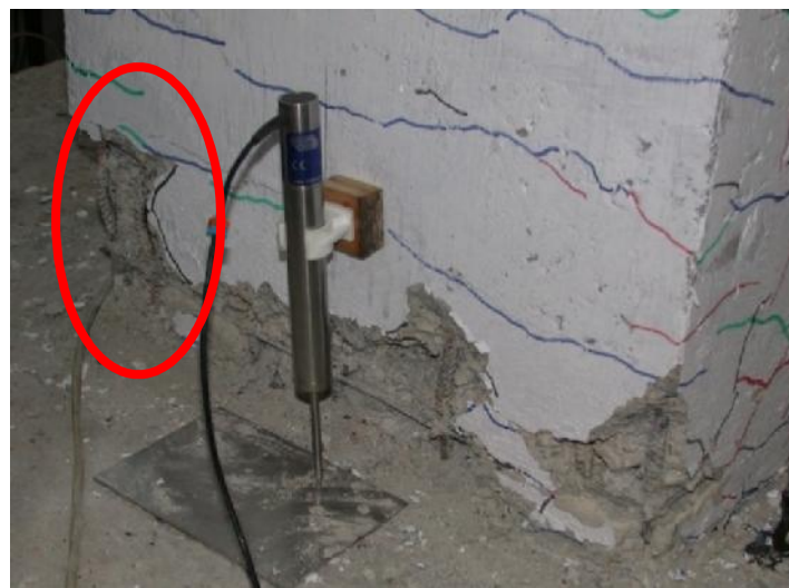
Figura 3.40 Encurvadura dos varões PO1-N2
