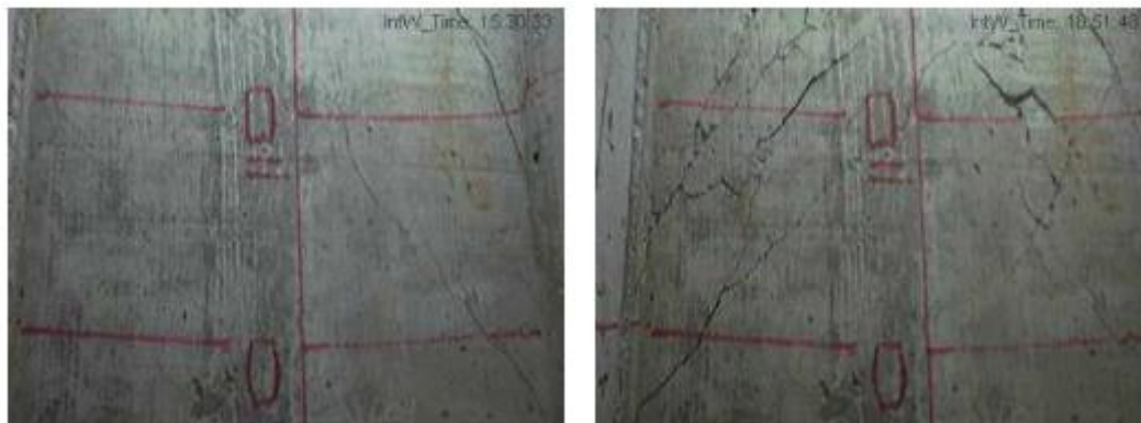
a) Drift 0.93% Figura 3.29 b) Drift 2.14% Danos na face interior Oeste do pilar PO2-N5
