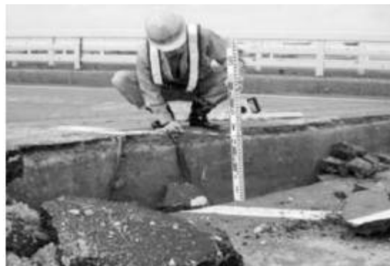
Figura 2.12 Assentamento da laje de transição de um viaduto (Niigata, 2004)
