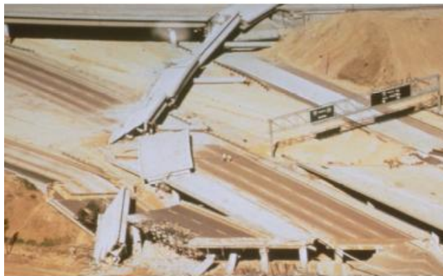
Figura 2.14 Colapso de um viaduto devido ao assentamento das fundações (San Fernando, 1971)
