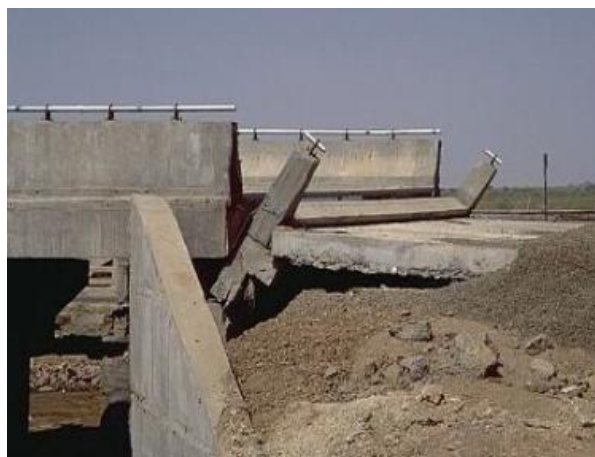
Figura 2.13 Dano causado pelo choque entre o tabuleiro e a zona de encontro (Gujarat, 2001)
