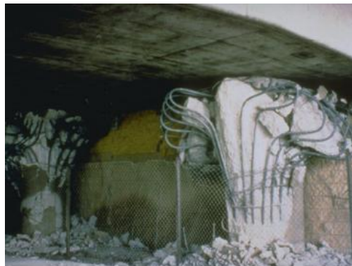
Figura 2.25 Incorreto confinamento devido à falta de armadura transversal (Northridge, 1994)
