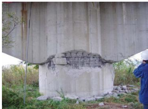
Figura 2.31 Rotura por corte em pilar curto (Niigata, 1964)
