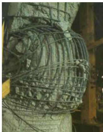
Figura 2.26 Incorreto confinamento devido ao escorregamento das cintas helicoidais (Northridge, 1994)
