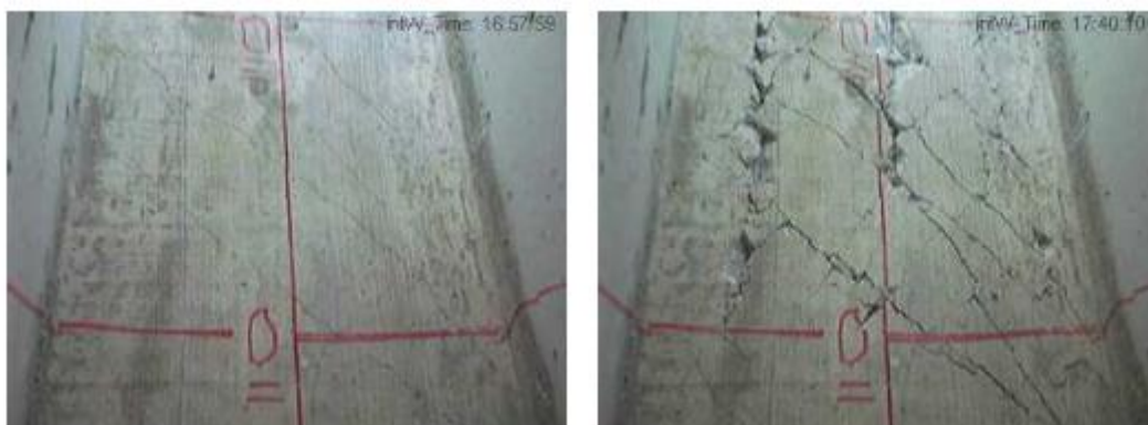
a) Drift 0.93% b) Drift 2.14% Figura 3.25 Danos nas faces interiores do pilar PO2-N4
