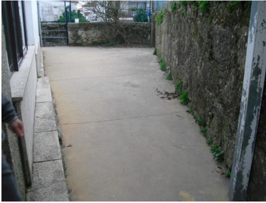
Figura 1. Área de cimento da parte lateral
