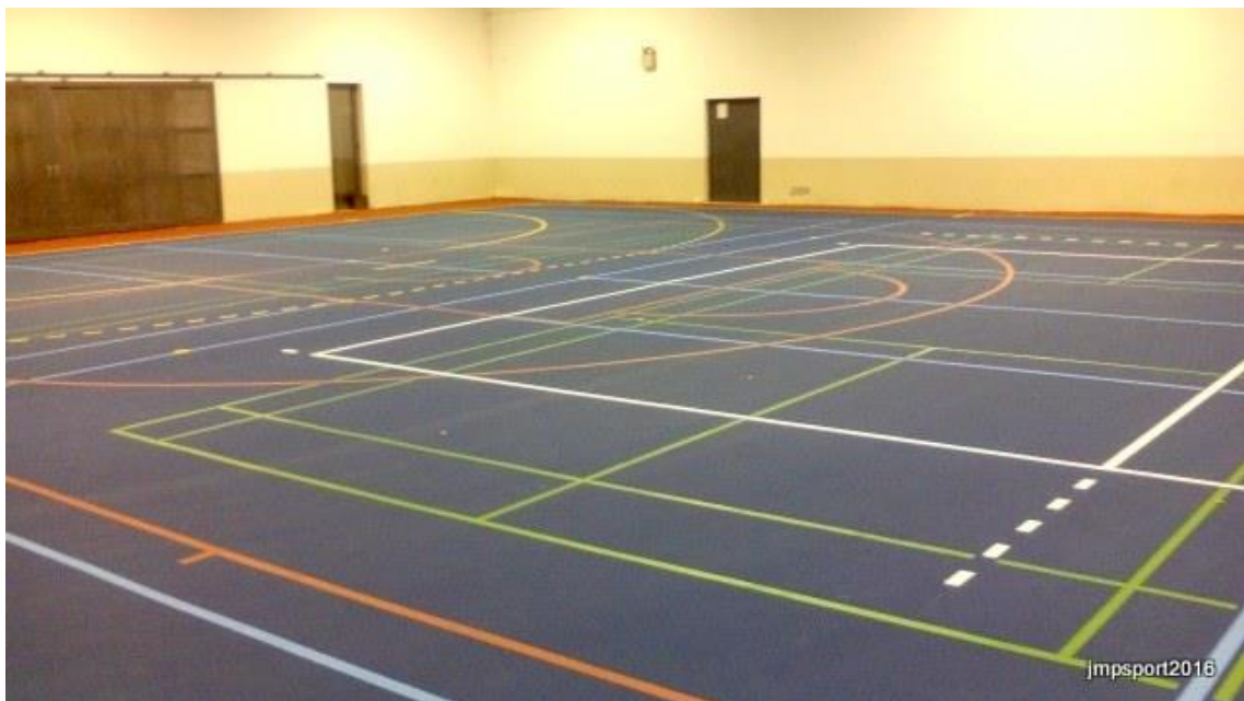
Figura 20 – Marcação de linhas JMP SPORT - Escola Secundária Cal. Duarte, Marinha Grande – excesso de marcações de linhas
