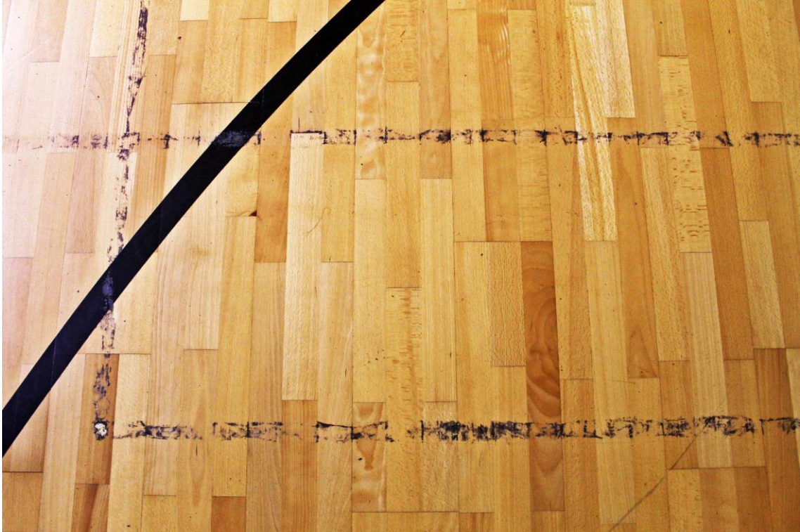
Figura 19 - Pavilhão da Escola Secundária de Monserrate - má manutenção de linhas, após retirada a marcação em fita cola
