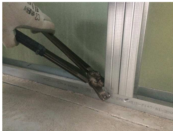
Figura 4.18 – Estrutura de montante duplo fixado à raia com o auxílio do alicate puncionador.
