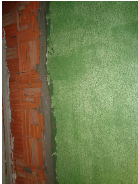
Figura 4.1 - Aplicação de uma demão de primário de aderência, do tipo Fondomur ou equivalente sobre o suporte em betão com baixas características de aderência.
