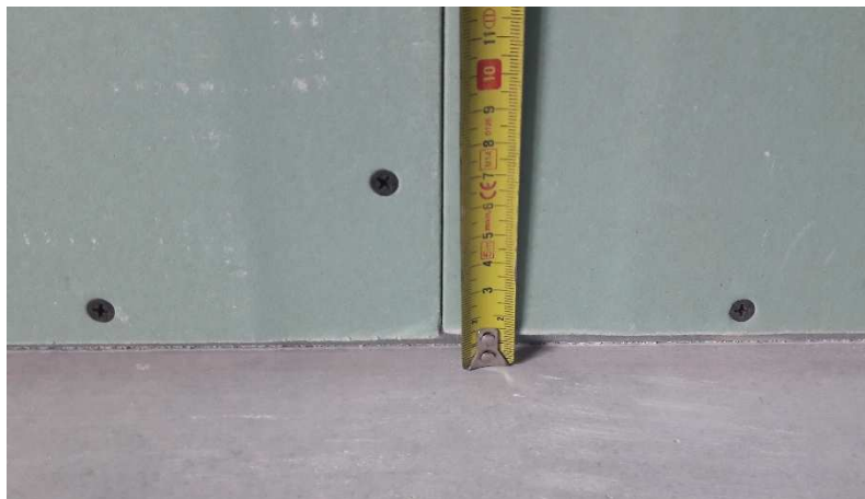
Figura 4.21 – Afastamento de cerca de 10 mm das placas de gesso cartonado à da laje de suporte.
