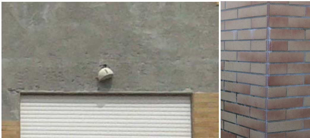
Figura 9 - Destacamento e empolamento do revestimento cerâmico das fachadas.
