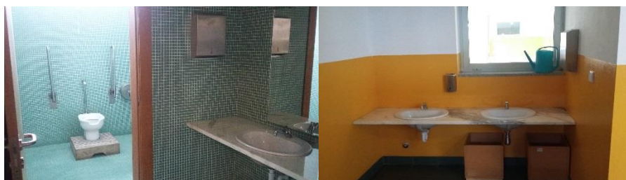
Figura 4. Casa de banho e lavatórios
