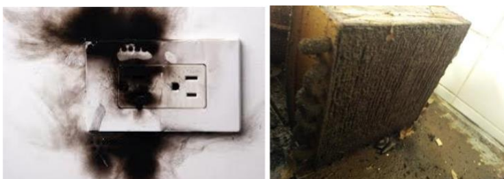
FIGURA 30 - TOMADA DANIFICADA POR CURTO-CIRCUITO E SISTEMA DE REFRIGERAÇÃO DE FRIGORIFICO OBSTRUÍDO
