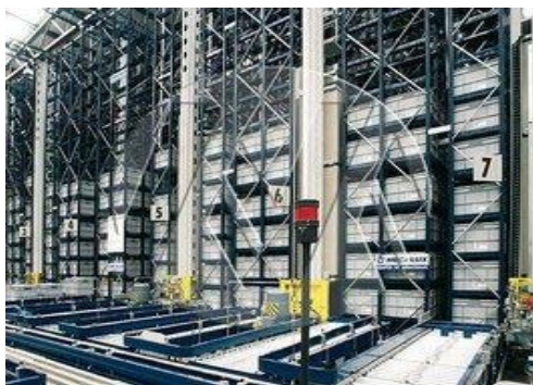
Figura 8 Armazém automático para caixas Miniload (Disponível: Mecalux)
