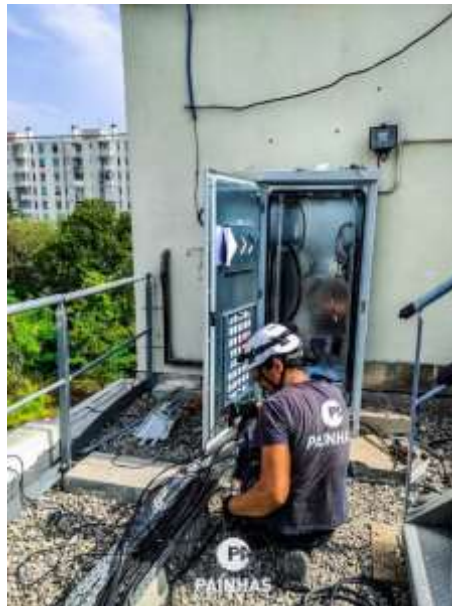
Figura 11. Instalação de Infraestruturas 5G Boost em Marselha, França
