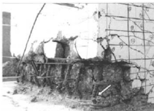
Figura 2.28: Rótula plástica com encurvadura dos varões longitudinais (Yeh et al. (2002))
