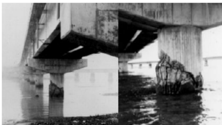
Figura 2.19: Sismo de Urakawa-Oki, 1982 (Japão). Rotura por corte.
