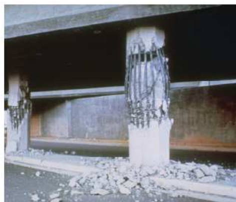
Figura 2.17: Sismo de San Fernando, 1971 (EUA). Sub-dimensionamento de armadura transversal.
