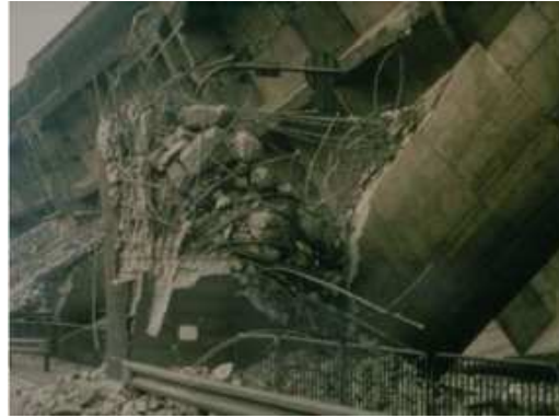
Figura 2.15: Sismo de Kobe, 1995 (Japão). Dispensa prematura de armadura longitudinal.
