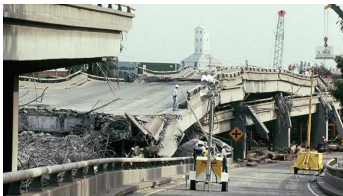
Figura 2.7: Destroços do viaduto Cypress após o sismo de 1989 em San Francisco.
