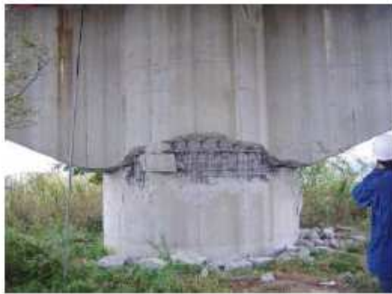
Figura 2.21: Sismo de Niigata (Japão, 1964). Rotura por corte.
