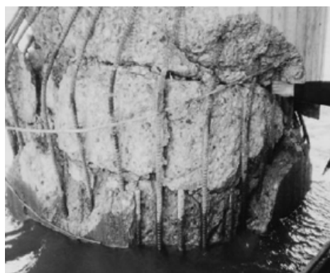
Figura 2.14: Sismo de Urakawa-Oki, 1982 (Japão). Dispensa prematura de armadura longitudinal.
