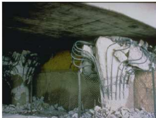
Figura 2.16: Sismo de Northridge, 1994 (EUA). Armadura transversal insuficiente.
