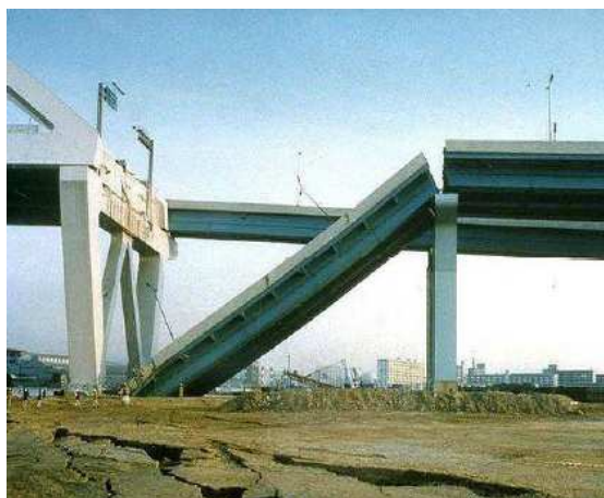
Figura 2.9: Sismo de Kobe, 1995 (Japão). Queda de tabuleiro da ponte Nishinomiya.
