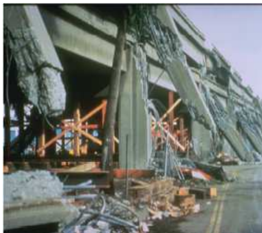
Figura 2.23: Sismo Loma Prieta, 1999 (EUA). Má conceção dos nós - Esforço transverso.
