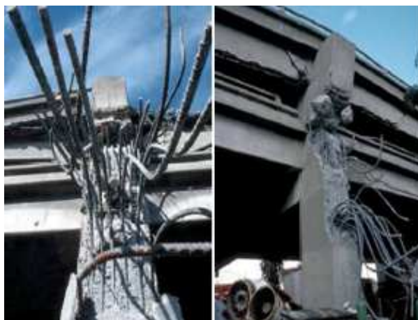
Figura 2.24: Sismo de Loma Prieta, 1999 (EUA). Má conceção dos nós - Esforço transverso.
