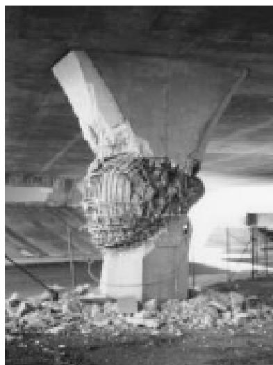
Figura 2.22: Sismo de Northridge (EUA, 1994). Rotura por corte
