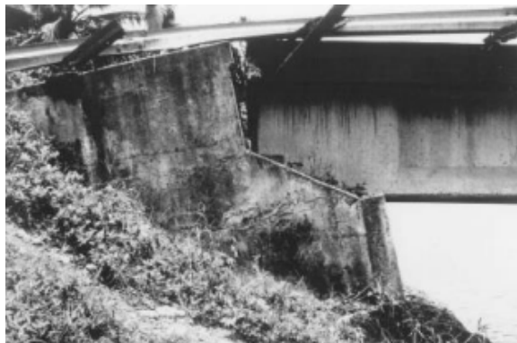
Figura 2.11: Rotação do encontro durante após um evento sísmico.
