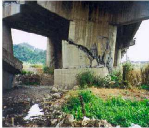
Figura 2.20: Sismo de 1999 (Taiwan). Rotura frágil por corte.
