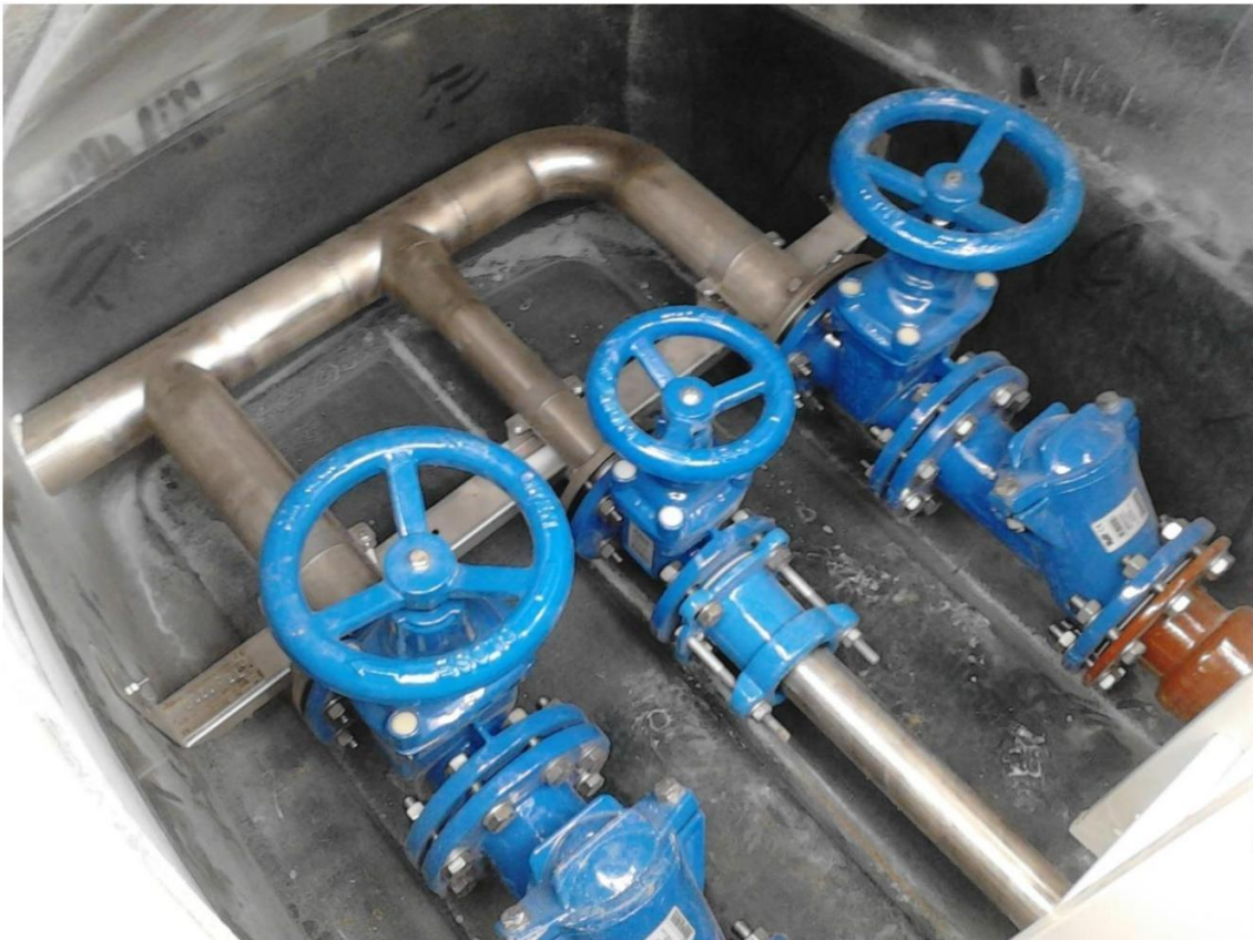
Figura 26 – Câmara de válvulas e descarga da conduta elevatória
