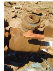
Fotografia 4.6 - Exemplo de válvula de medição próximo da cabeça de poço
