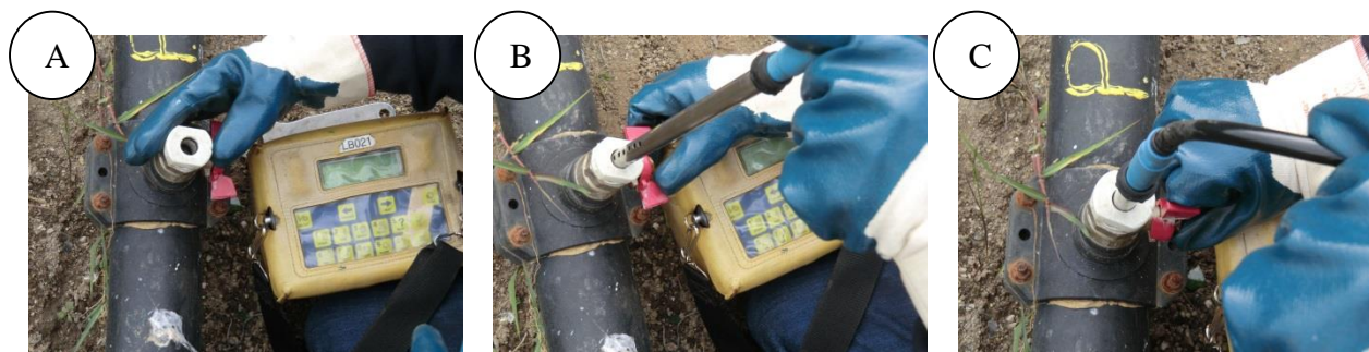
Figura .5.4-Medição de temperatura nas válvulas junto a cabeça dos poços.
