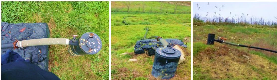
Fotografia 4.3 - Exemplos de cabeças de captação de biogás
