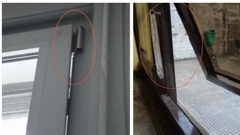
Figura 24_ – Degradação de dobradiças e dos mecanismos de abertura e fecho
