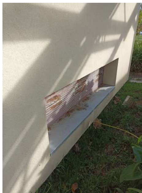
Figura 6.3 – Grelha de ventilação do PT
