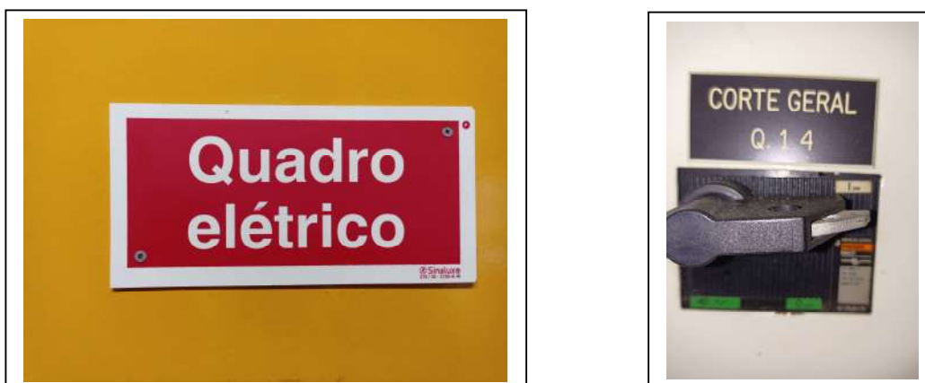
Figura 6.1 - Porta de quadro elétrico e corte geral no quadro setorial
