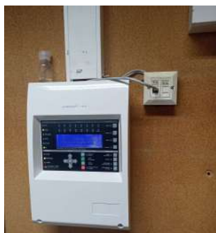
Figura 6.11 - Central de sinalização e comando
