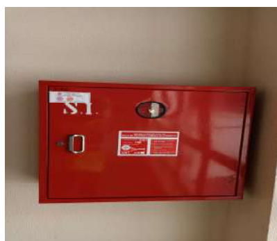
Figura 6.9 - Boca de incêndio tipo carretel
