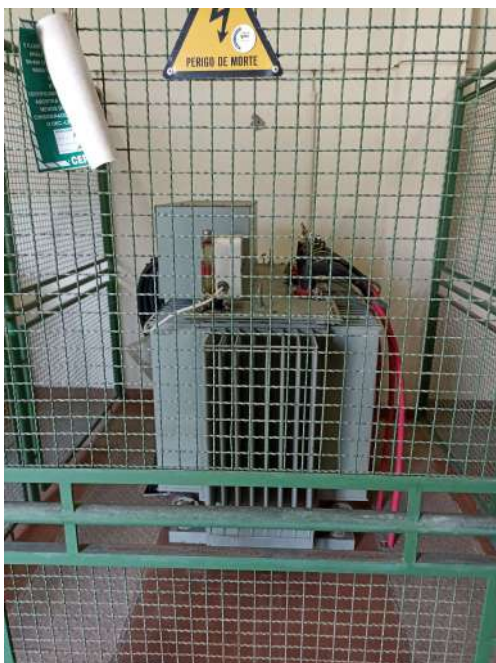
Figura 6.2 – Posto de transformação
