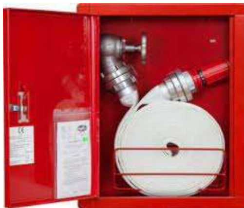
Figura 5.3 - Boca de Incêndio Armada Tipo Teatro (APTA, 2022).
