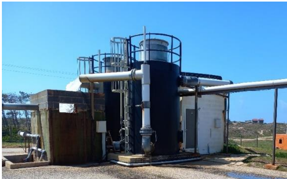
Figura 3.3: Estação de ozono. Fonte: Fotografia original (2022).
