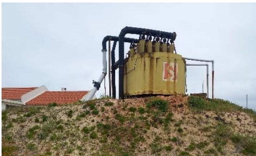
Figura 3.1: Tanque de distribuição de água à quarentena. Fonte: Fotografia original (2022).
