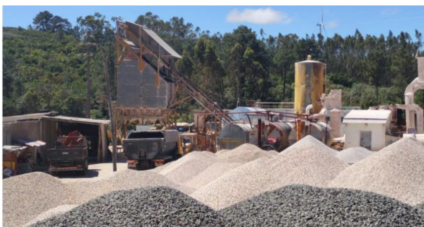
Figura 3.1: Panorâmica geral da central de fabrico de misturas betuminosas a frio em pampilhosa da serra (Construções JJR e filhos AS)
