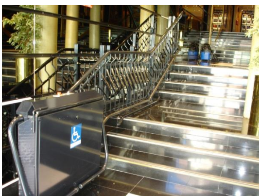
Fig. 105 - Plataforma elevatória no Casino
