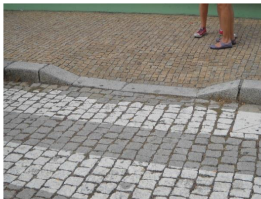
Fig. 22 - Pavimento e rebaixamento inadequados
