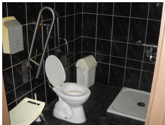
Fig. 78 - Instalações Sanitárias no Bar da Praia
