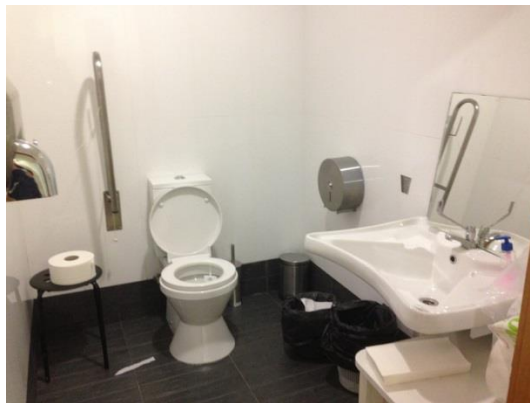
Fig. 116 - Vista geral da instalação sanitária
