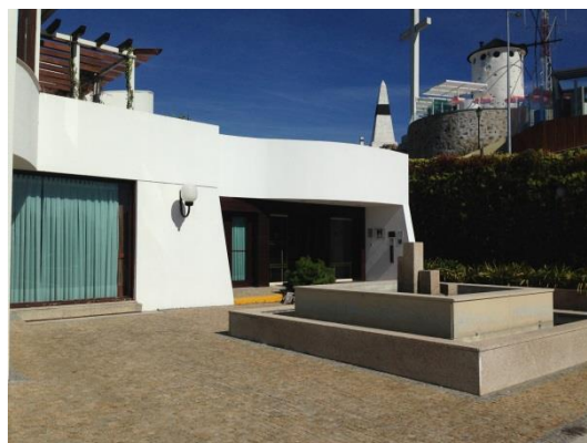
Fig. 40 - Pavimento descontínuo no Hotel São Félix
