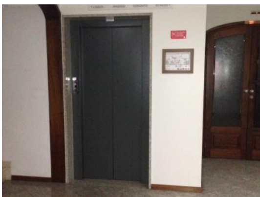
Fig. 49 - Elevador no Hotel Sol Póvoa
