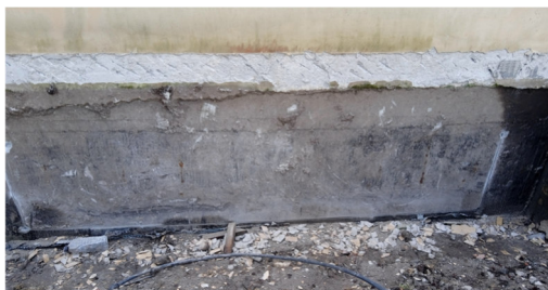
Figura 38: Remoção cerâmico da Fachada
